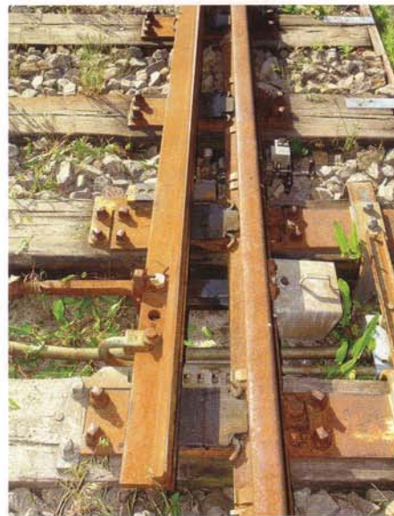
Abb. 2: Weiche ordnungsgemäß gesichert mit Hv 73
